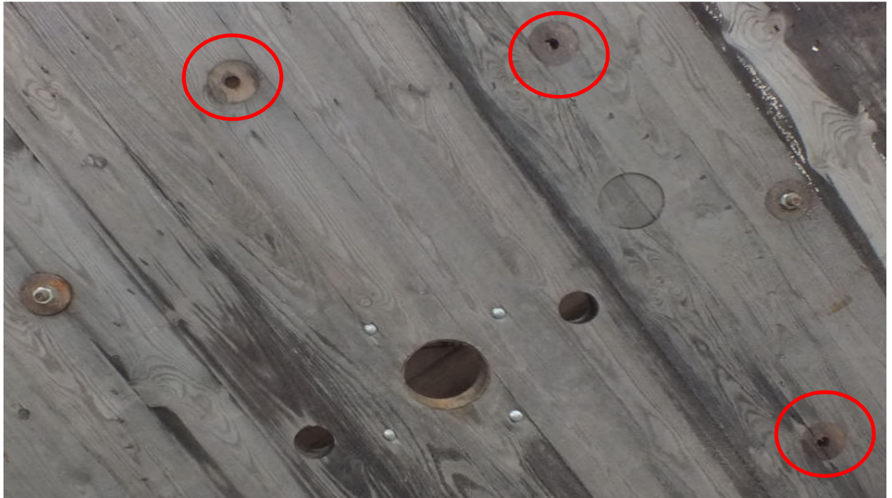
KUVA 5, MO = METALLIOSIA PUUTTUU
